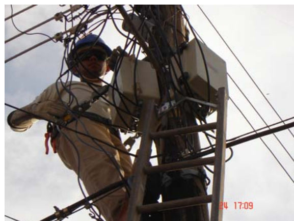
Figura 10. Poste de Distribuição com 02 URMEs
