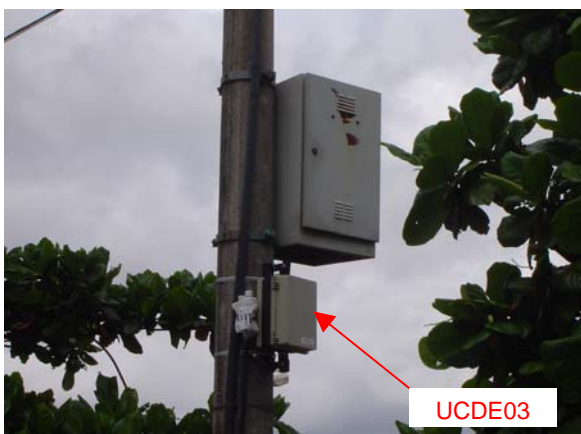
Figura 7. UCDE: Instalação em Poste de Iluminação/Transformador
